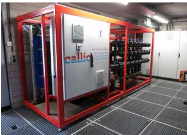
Prefab TEO in pandige installatie met onder andere besturingstechniek, filtratie, pneumatiek en warmtewisselaar.
