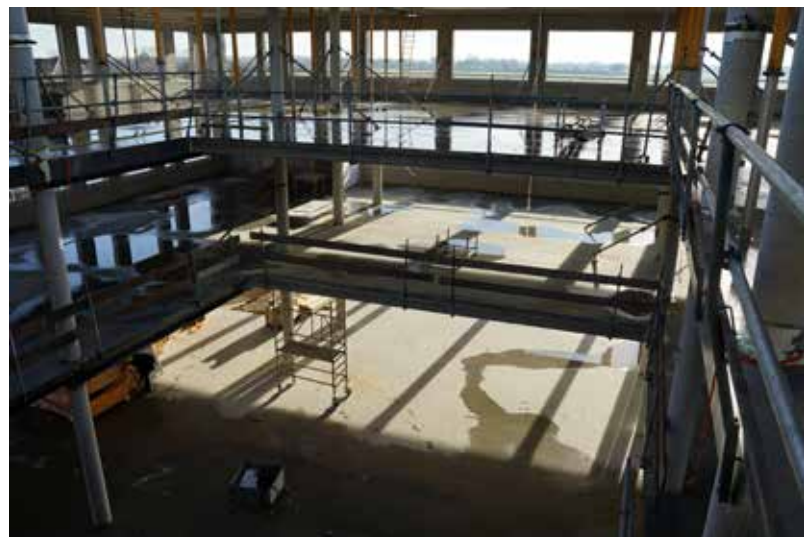
In november 2021 zullen leerlingen, docenten en ondersteund personeel het nieuwe, drielaagse gebouw betrekken.
